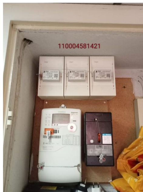
Figura 18 – Exemplo de instalações onde existe espaço para a instalação de Filtro(s) PLC, no mesmo compartimento e no mesmo plano do EMI, e onde foi aplicado uma caixa individual em cada um dos Filtros PLC;
