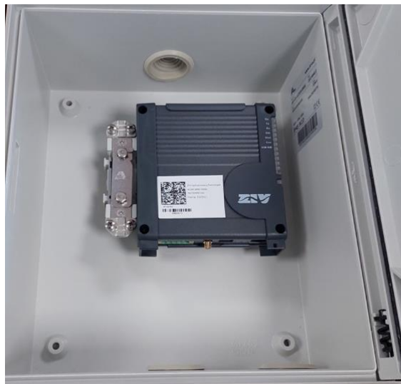
Figura 21 – Caixa P100 com Gateway PLC instalada no interior;
