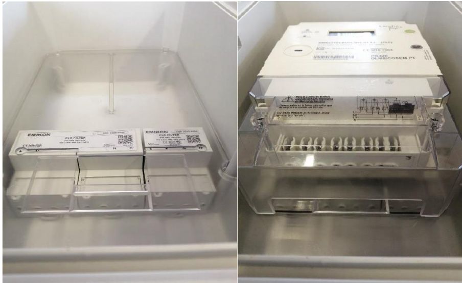
Figura 19 – Caixa de contagem com 3 Filtros PLC montados por trás da platine
